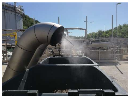
FIGURA 29 – SISTEMA DEODORIZZAZIONE VASCA DISOLEATURA/DISSABBIATURA
